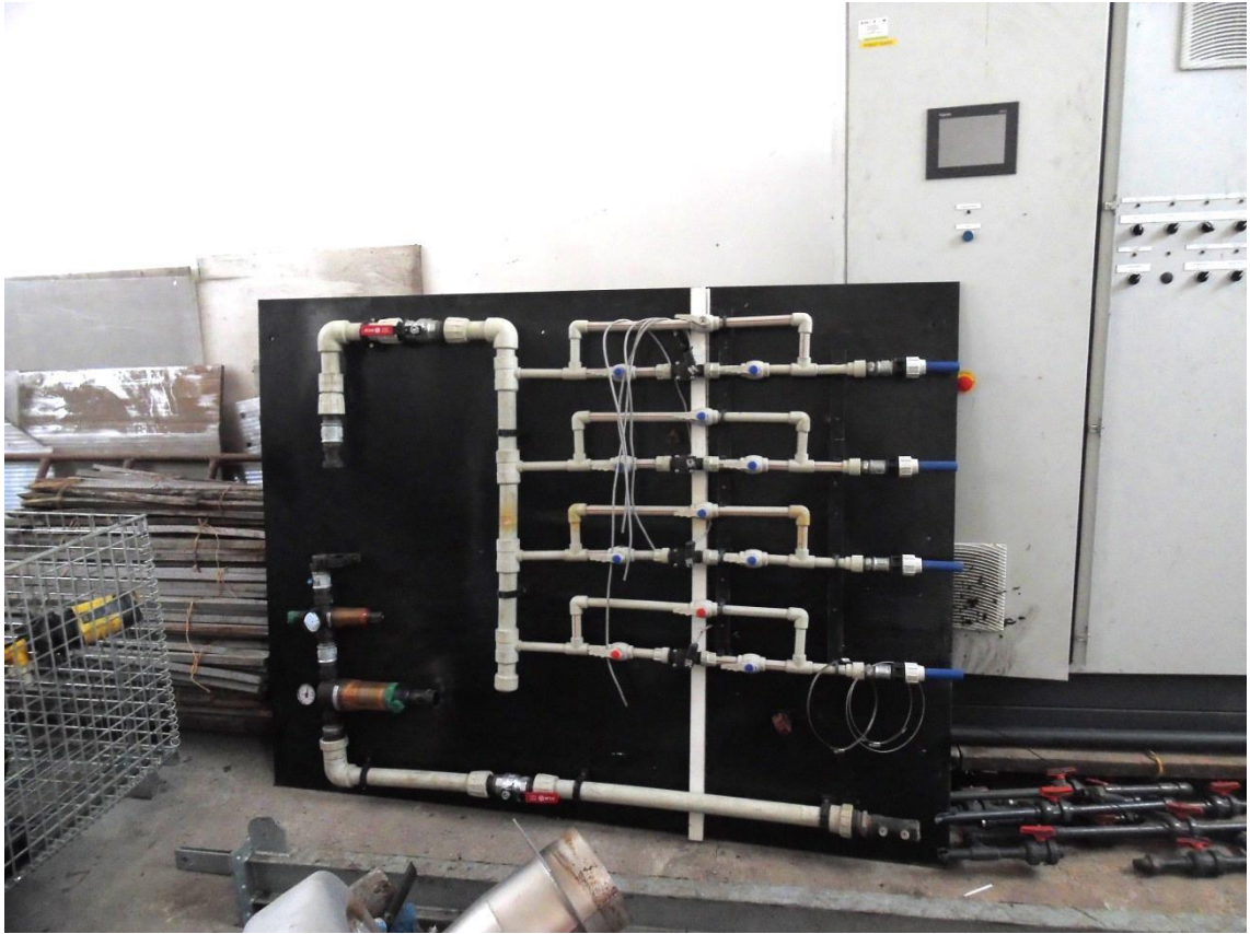
7. Panel zraszania kompostowni odpadów organicznych
